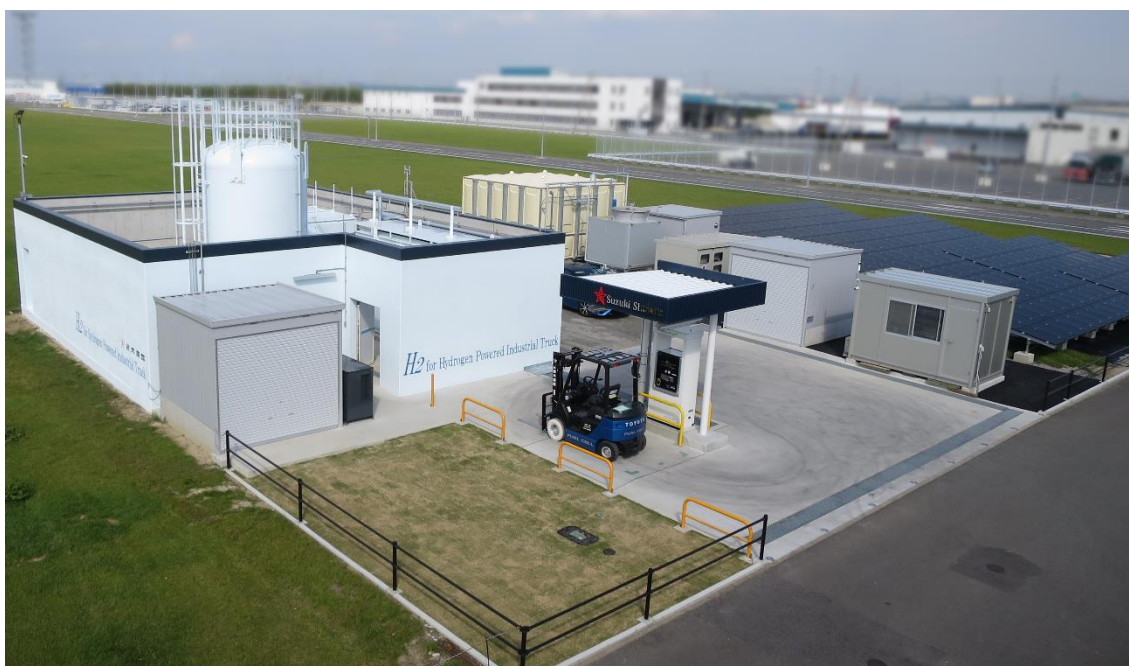
【 燃料電池フォークリフト用水素充填所外観 】
